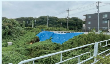
下総橋法面崩壊の様子
