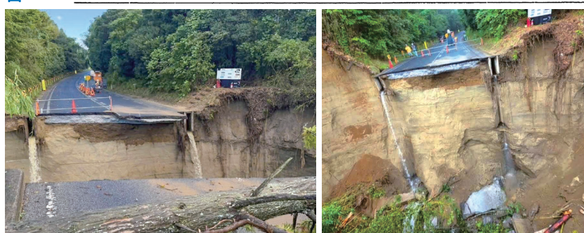
台風25号で旧外房有料道路の大規模な道路崩落
